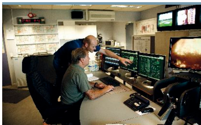
Fra kontrolrummet på Knudmoseværket kan driftschef Ove Jespersen se og styre alle informationer, men det samme kan også tilgås via Internet.
