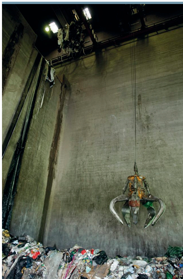
Styringen indeholder en anti-sving funktion, der stort set eliminerer oversving af kranovkølen, når den som her skal styres for enden af de lange kabler.
