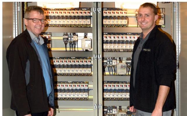
Teknisk chef Kurt Nordholt, NTO, og luftfartstekniker Henrik K. Jensen, Billund Lufthavn, har samarbejdet tæt om implementeringen, og de har nu trygheden ved at vide, at dokumentationen for systemet holder rede på, at alt i tavleskabene er forbundet korrekt.
